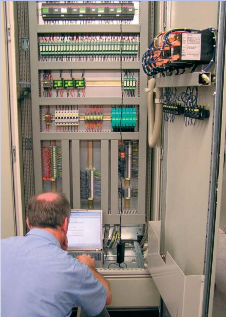
Der LAUDA Servicetechniker prüft die elektrischen Anschlüsse der Anlagen vor Ort.
