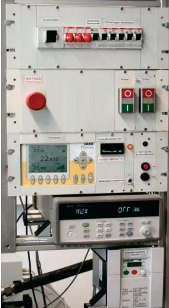
Einbindung der LAUDA Command Konsole in die Anlagensteuerung.
